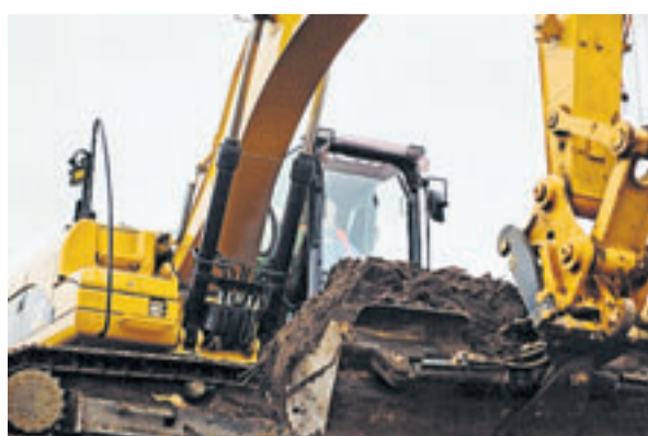
Mit Kettenbaggern werden nicht nur große Mengen Material bewegt, auch die Profilierungen von Lärmschutzwänden werden so erledigt.
