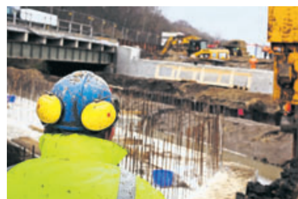
Vorgabe an die Bauunternehmer ist es, den Verkehr auf der Autobahn möglichst wenig zu behindern. Für Brückenverbreiterungen muss die A1 dennoch gesperrt werden.
